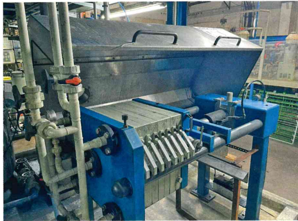
Abb. 7: Diskontinuierlich betriebene Kammerfilterpresse zur Abreicherung des cyanidischen Silberelektrolyten
