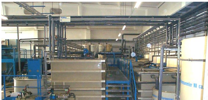
Teilansicht der Abwasseranlage mit Chargenbehandlung
