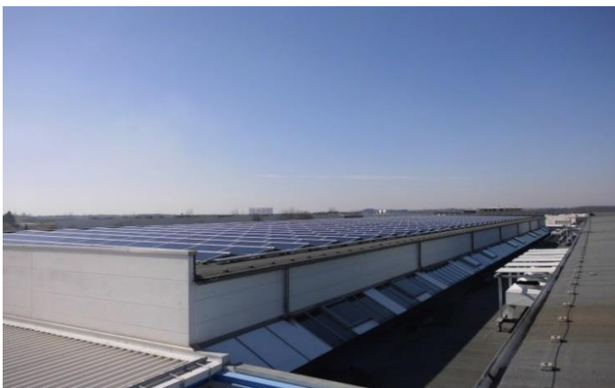
Solaranlage auf der Dachfläche der Lager- und Logistikhalle
